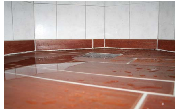
Feil fall til sluk
