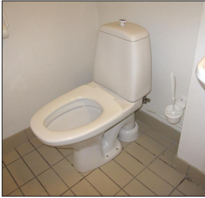
Tradisjonell plassering av WC systerne
